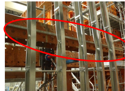
写真2 仕上材撤去後の状況 (Case3-1)
