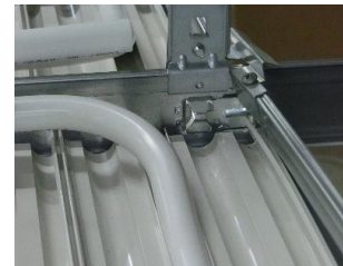
写真8 ジョイントの外れ
