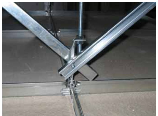
写真3 ハンガーの接続状況 (メインバー直交方向)
