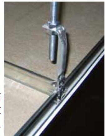
写真2 パイプハンガー
