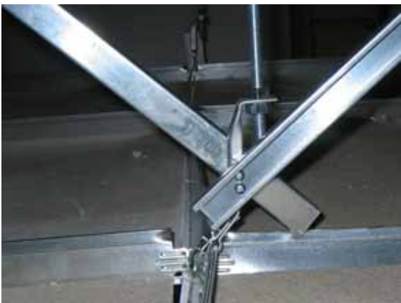
写真 5 パイプハンガー変形状況
