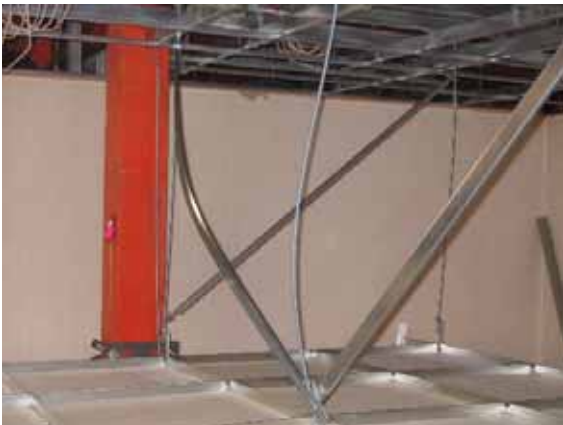
写真 4 プレース座屈状況
