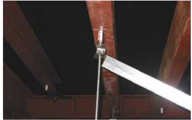
写真 1 圧縮側ブレース上部金具ボルトの曲がり
