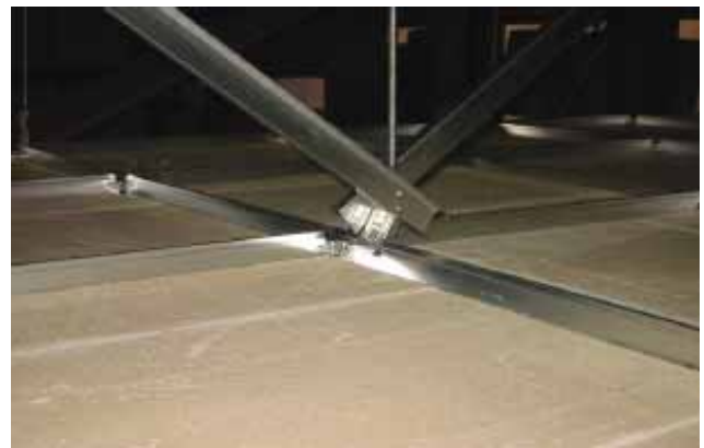
写真 2 ブレースビス止めハンガーの倒れ変形
