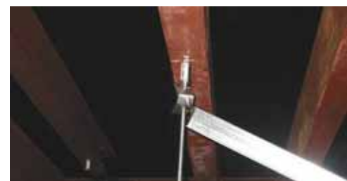
写真6 試験 No.8 圧縮側ブレース上部金具ボルトの変形
