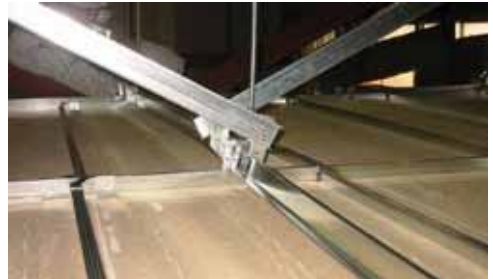
写真4 試験 No.7 試験後ブレース取付部変形
