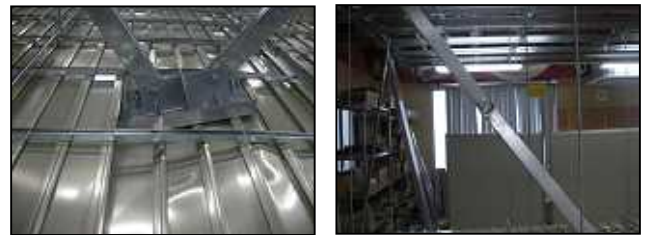
写真3 終局状況(仕上げ材:スパンドレル)
