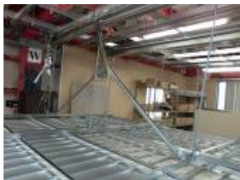
写真1 H-5 ブレース座屈状況
