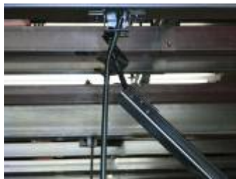
写真2 H-3 ブレース取付金具の破壊状況
