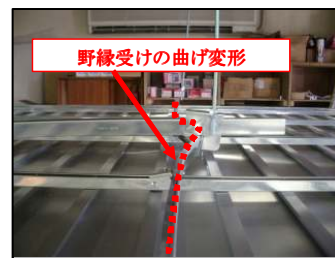
写真3 野縁受けの変形状況
