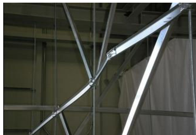
写真1 水平補強材の座屈 (ジョイント部)
