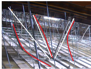
写真4 斜め部材座屈状況 (神戸波 150%)
