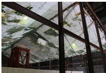
写真6 天井材の損傷状況
