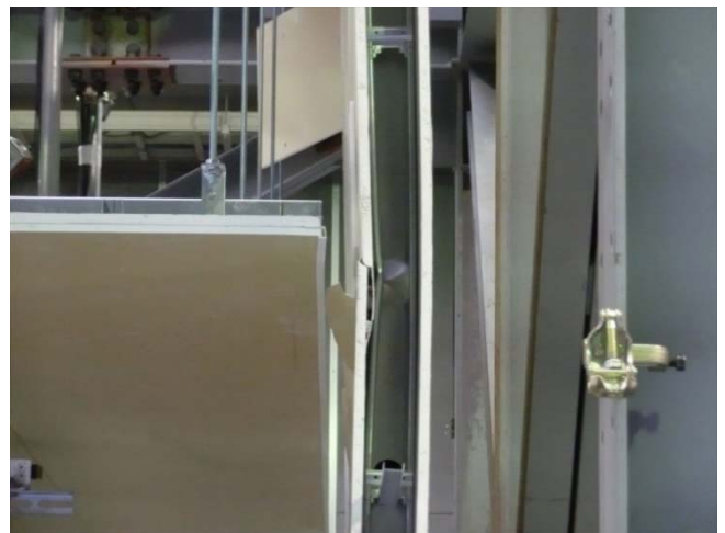
写真 2 スタッドの局部座屈
