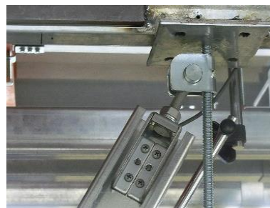
a) 斜め部材上端取付金具の破損
