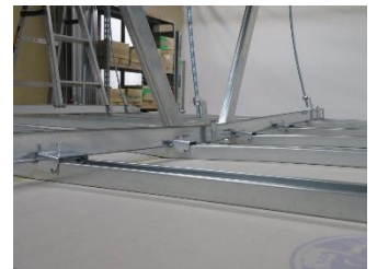
写真 8 野縁受けの曲げ変形
