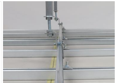
a)Case2-1 吊りボルトの曲げ変形
