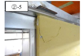
写真7 ボードの割れ
