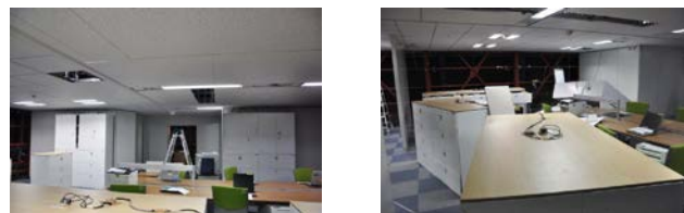
実験室1 実験室2 図-2 JMA 神戸 75%の入力地震動での天井落下写真
