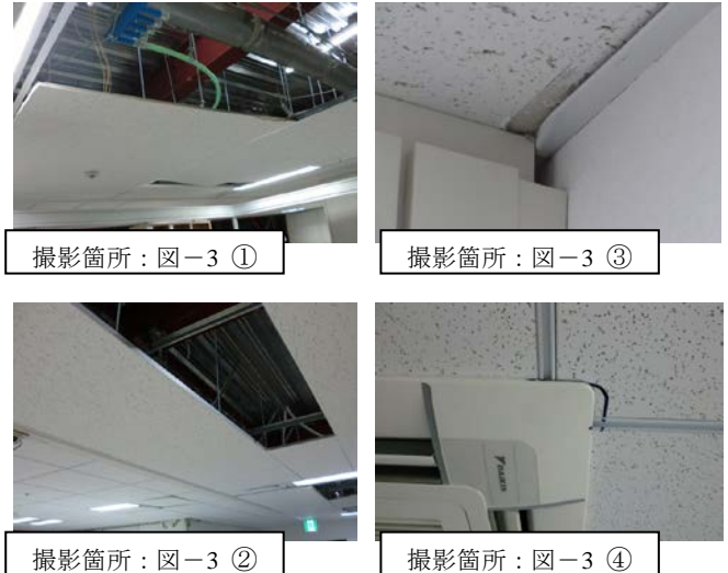
図-5 加震後のシステム天井下地及びパネル等の状況
