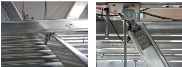
写真3 変形状況(試験 1-1)
