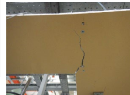
写真2 開口部隅部の面材割れ
