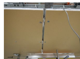
写真1 面材目地部の割れ
