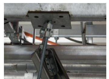
写真1 ブレース上部金具の損傷
