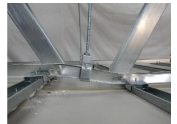
写真2 野縁受けの曲げ変形
