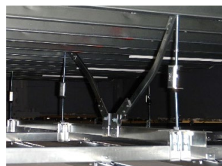
写真1 X方向斜め部材の座屈
