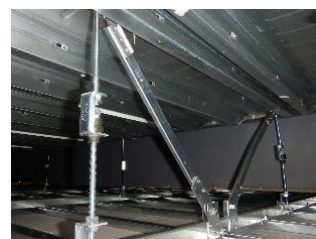
写真2 Y方向斜め部材の座屈
